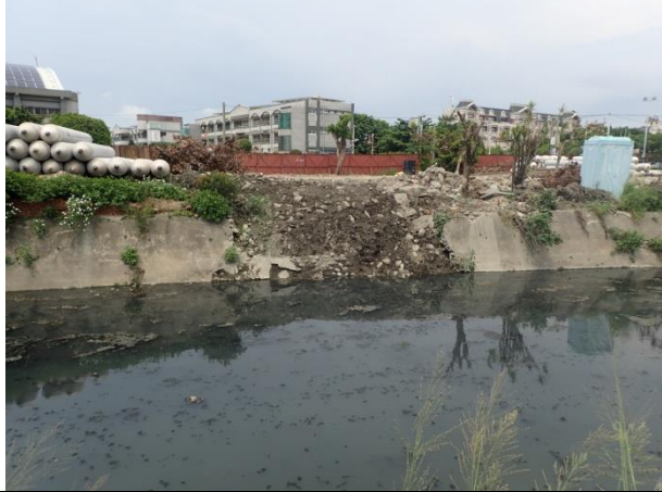
施工過程發現土石有崩落至河道之情況
