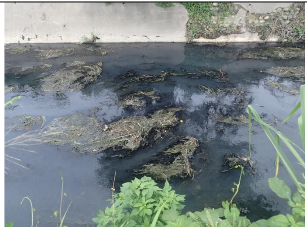
水質仍惡劣且發散臭味
